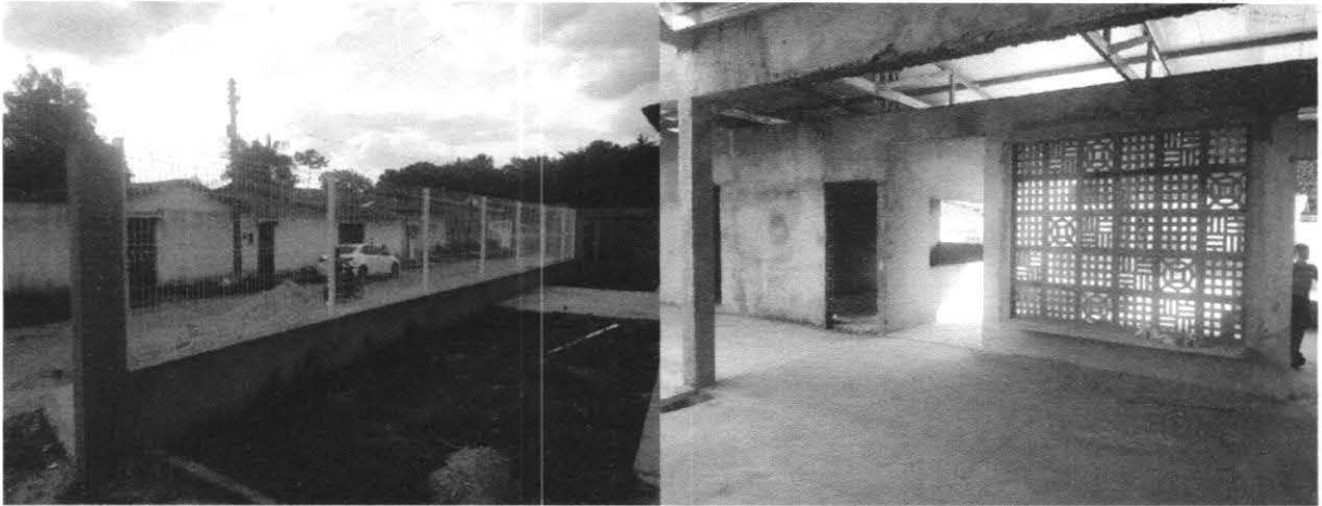
Fechamento frontal do terreno com piso executado na área interna da obra
